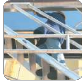
Plataforma completa con trampilla para el acceso al último nivel
