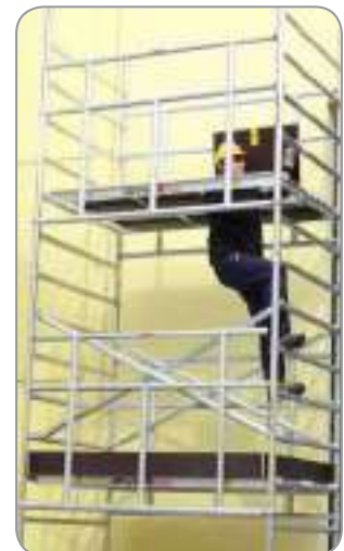
8. El operario puede acceder al nivel superior a través de la trampilla
